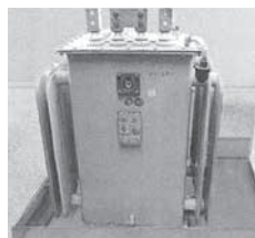
変圧器（トランス）
