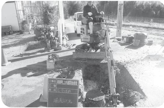
漏水復旧 速やかに
