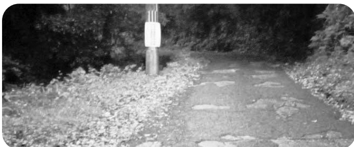
早期改修が望まれる町道白栖撰原線
