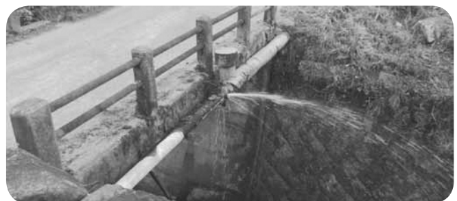
老朽化した石寺地内水管橋
