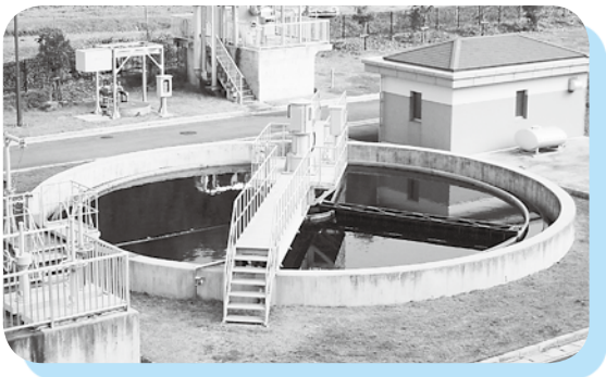
最終沈澱池(和東中央浄化センター)
