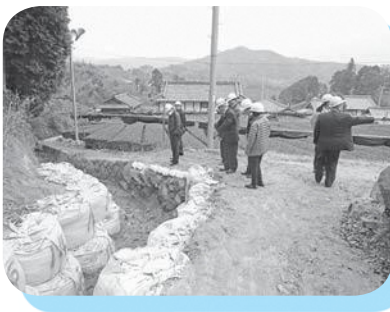
石寺地内被災現場
