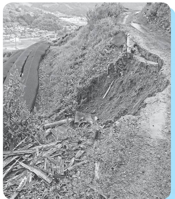
被災現場（釜塚地内）
