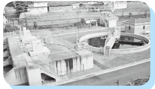
下水道処理施設の災害時の対策は
