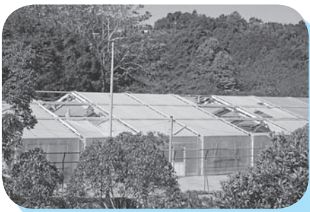
傷んだBGプール上屋テント
