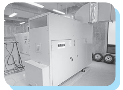
浄水場発電機
