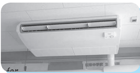
昨年設置された中学校の空調設備
